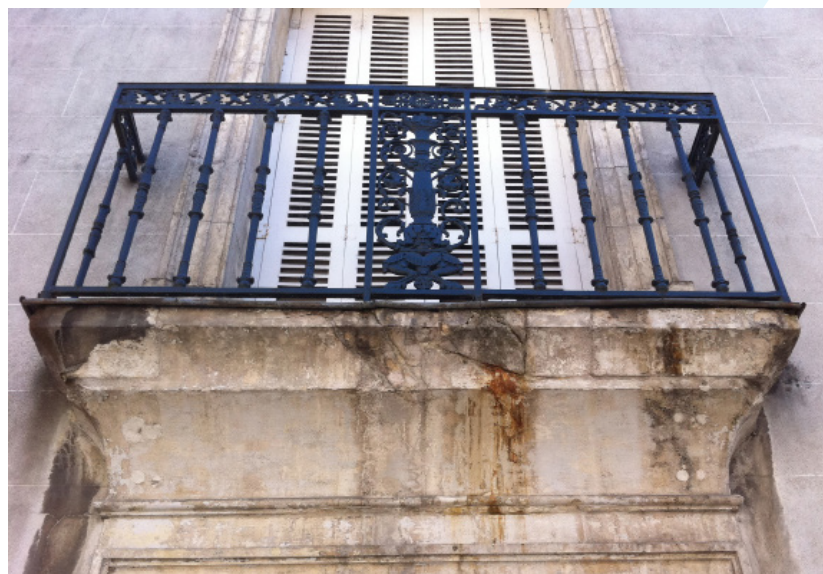
Corrosion des armatures
