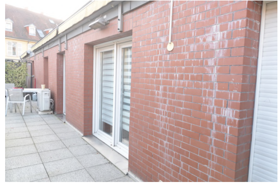
Expertise de l'état hydrique de la maçonnerie en briques (Expertise- 2019 et 2021)
