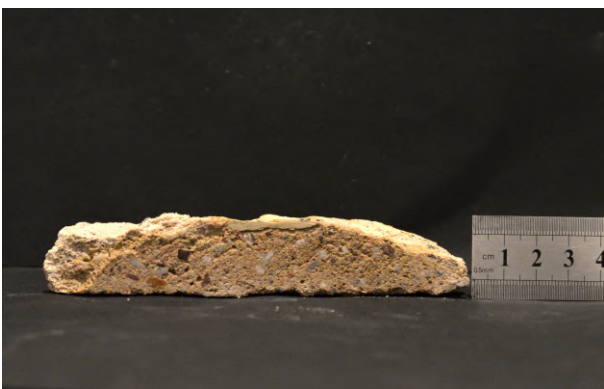
Contrôle qualité d'enduits mis en oeuvre (Expertise judiciaire - 2018)
