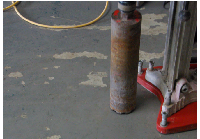
Caractérisation d'un revêtement industriel altéré (Expertise judiciaire - 2019)
