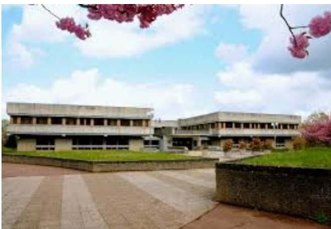
Analyses des altérations du béton architectural de la cité judiciaire de Senlis (Mescla - 2018)
