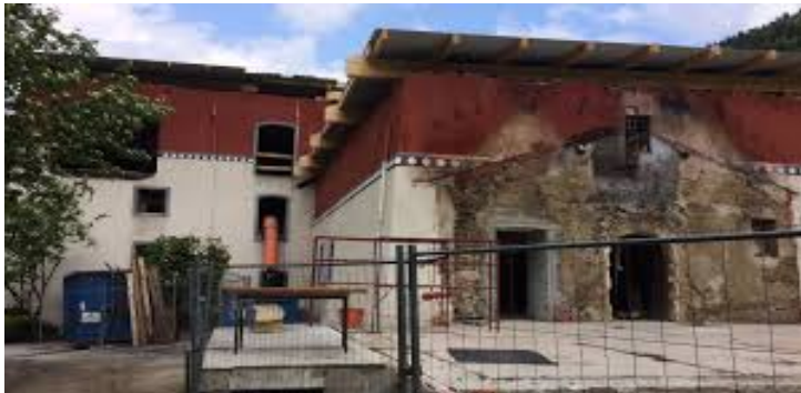
Diagnostic de l'institut Karma Ling à Arvillard après un incendie (P. Barbeyer, architecte du Patrimoine - 2018)
